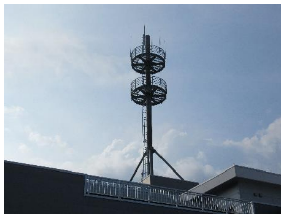
新川本部消防救急無線基地局
