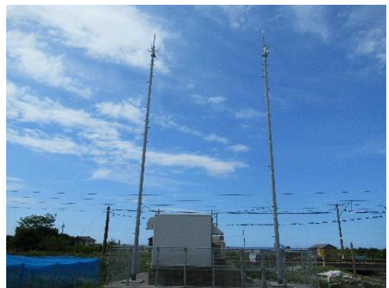
朝日消防救急無線基地局
